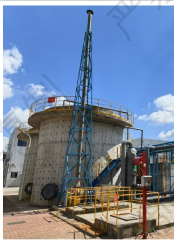
水喷淋塔+除雾器+活性炭吸附装置
