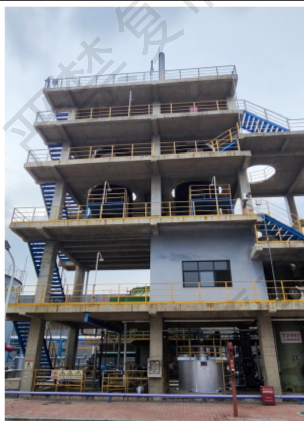
二级电除雾器+二碱吸收塔
