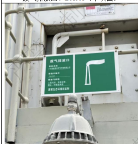
废气排放口：DA002（原有项目）
